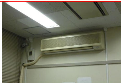
西8唯一のエアコン
