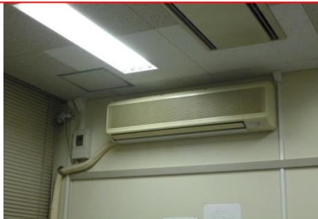
西8唯一のエアコン
