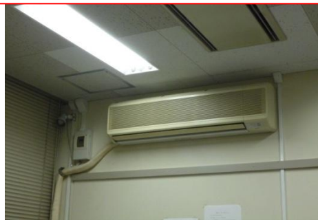
西8唯一のエアコン
